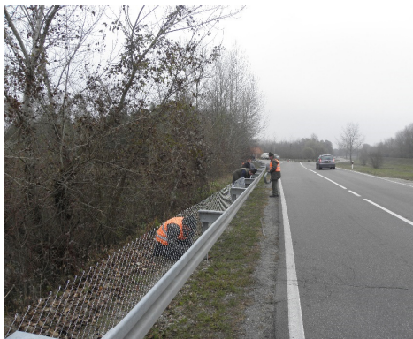
Foto; Marijan Grubešić – zaštitna ograda uz prometnicu
